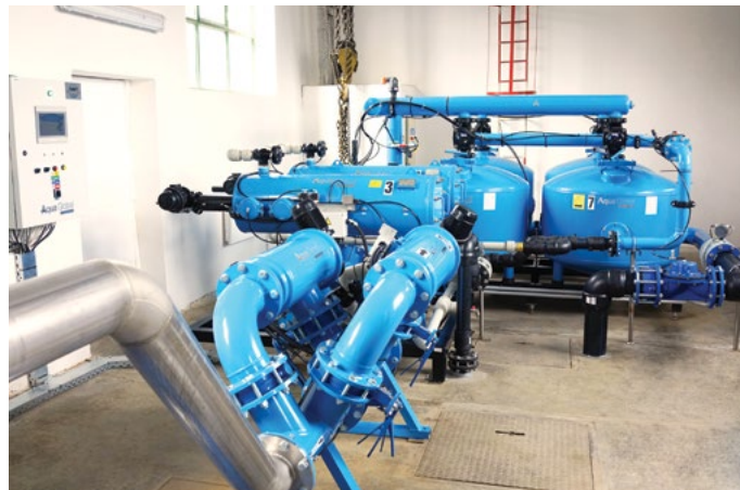
Třístupňový filtrační systém navržený a vyrobený v Izraeli pro filtrační technologické vody. Výkon filtrace 150 m 3 /h. Kombinace několika filtračních technologií efektivně a ekonomicky řeší využití říční vody v průmyslové zóně v Otrokovicích
